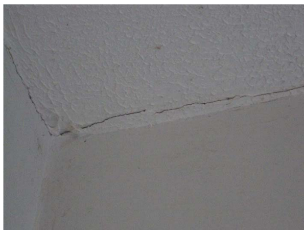
FOTO 2: RACHADURA NO FORRO COM INFILTRAÇÃO: Em menos de 5 anos, tempo de garantia das casas, muitas em diferentes RUCs começaram a apresentar graves problemas em suas estruturas, comprometendo a segurança dos moradores. (Foto: Suelem Cardoso, agosto de 2017).
