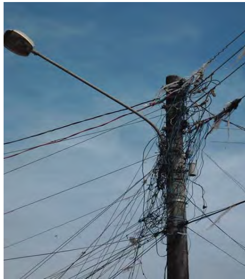
Figura 06: Má condições do fornecimento de energia
